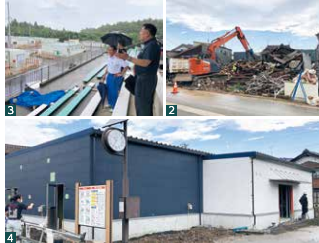
1 地震によって道路まで崩れ落ちた土砂 2 各地で家屋等の解体作業が進む 3 競技場を改修して設営された仮設住宅を諸岡町長が視察 4 最も被害が大きい商店街の復興のため建設された仮設商店街
