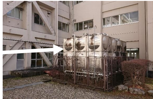
【中庭に設置されている貯水槽】
