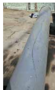
▲経年化によりひび割れした水道管
