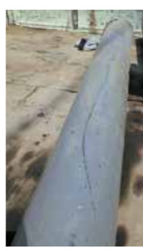
▲経年化によりひび割れした水道管
